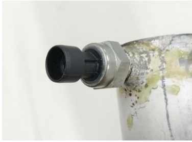
Fig. 15 - Ponto de instalação do sensor de pressão no tubo.
